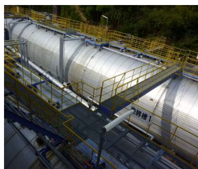
京都府南丹市カンポリサイクルセンター(株) 乾式メタン醗酵槽
