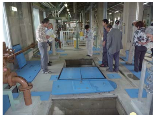
ばっき槽の中を開けて中の水処理状況を観察
